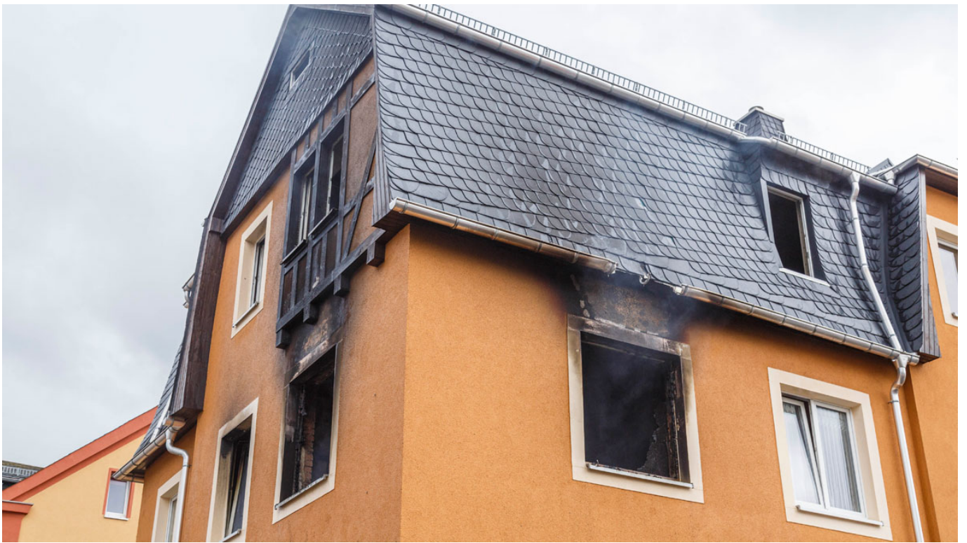
_ Die Fassade des Hauses wurde ebenfalls in Mitleidenschaft gezogen | Foto: Jens Uhlig
